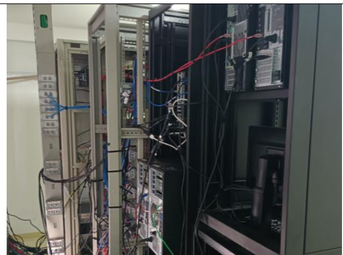
Foto 11 – Vista traseira superior dos racks
