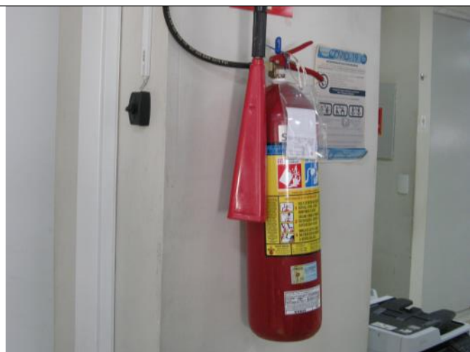
Foto 4 – Extintor de incêndio (externo)
