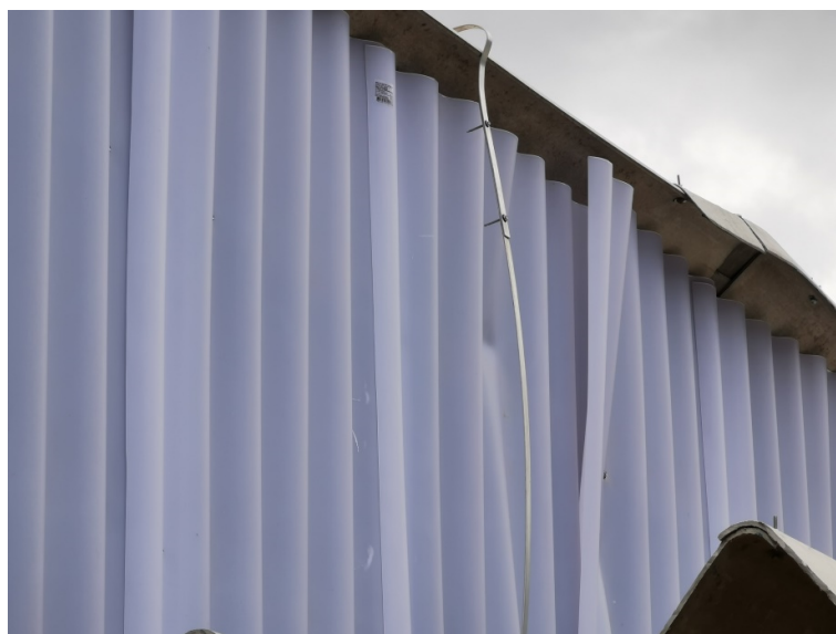
Foto 24 – Detalhe do fechamento e do sistema de SPDA realizado na reforma e fixado inadequadamente.
