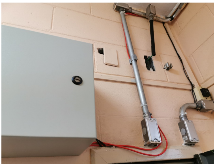
Foto 20 – Detalhe de quadro novo com condutor elétrico aparente. Ademais, não é possível identificar o condutor de aterramento.
