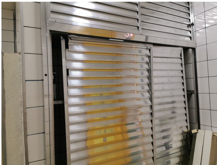
Foto 28 – Vista do armário do banheiro em condições inadequadas.
