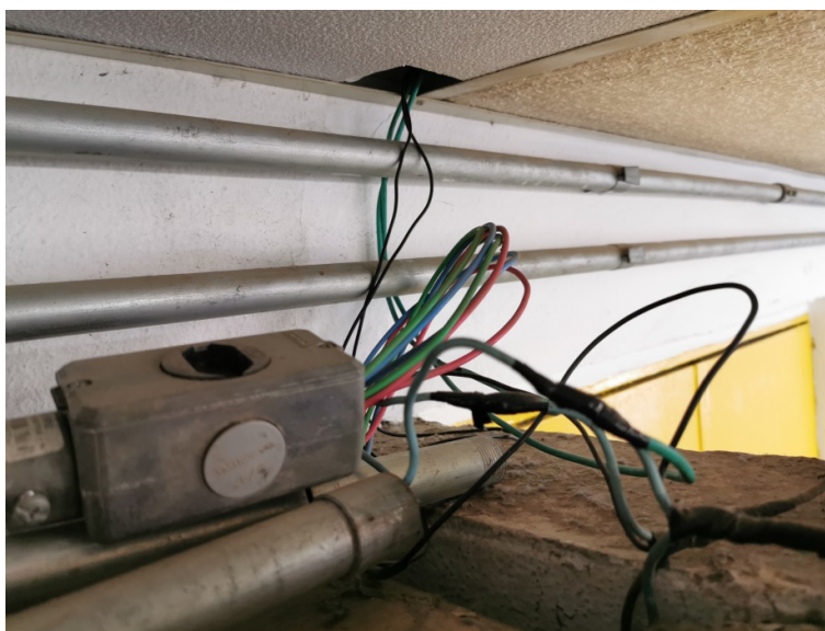
Foto 16 – Instalação elétrica apresentando condutores aparentes, localizada entre parede e forro do refeitório, aparentemente em uso.
