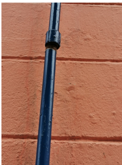
Foto 33 – Detalhe da instalação elétrica das luminárias da caixa d'água, demonstrando que os eletrodutos foram pintados, mas não substituídos.
