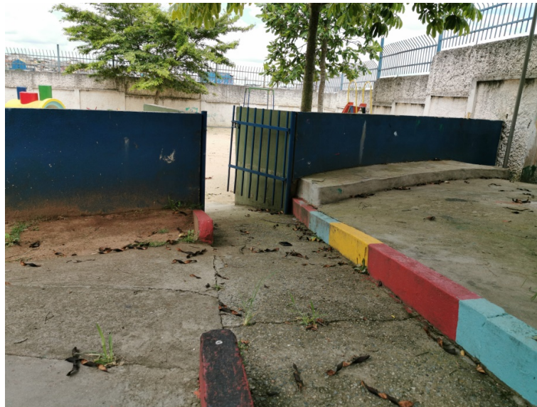
Foto 7 – Rampa de acesso ao parquinho sem acessibilidade.
