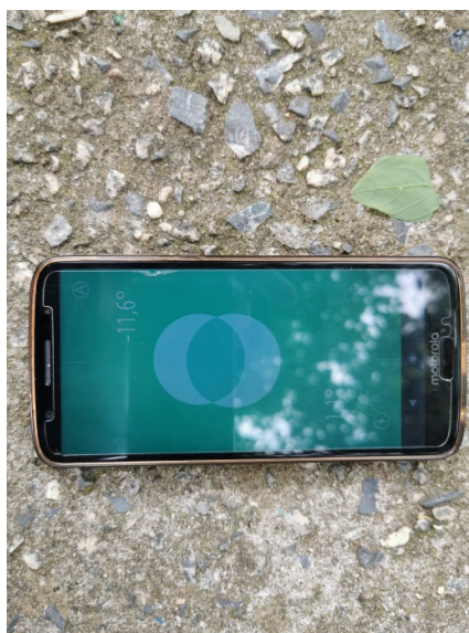
Foto 8 – Detalhe da inclinação da rampa de acesso ao parquinho – 11,6° em desacordo com a Norma Técnica ABNT NBR 9050:2015.
