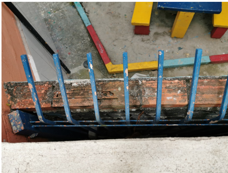
Foto 3 – Detalhe do vão entre rampa de acesso e parquinho. Frisa-se que tanto a mureta de alvenaria quanto a grade não possuem função arquitetônica tampouco estrutural.
