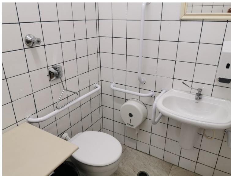
Foto 32 – Detalhes das barras de apoio no banheiro acessível - foram utilizados materiais de qualidade inferior à prevista no Contrato.
