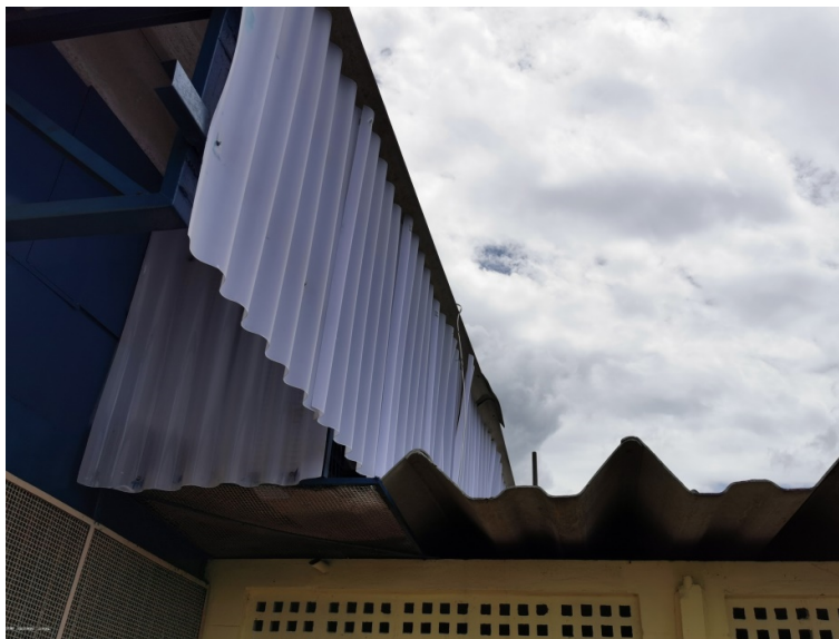
Foto 23 – Detalhe de fechamento da cobertura realizado na reforma apresentando falhas de fixação.
