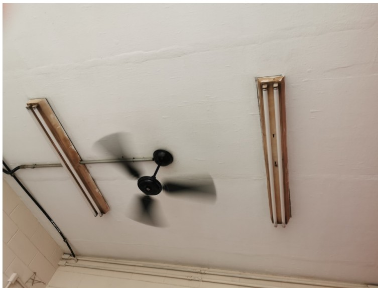
Foto 19 – Detalhe luminárias antigas não substituídas, em desacordo com o memorial descritivo.
