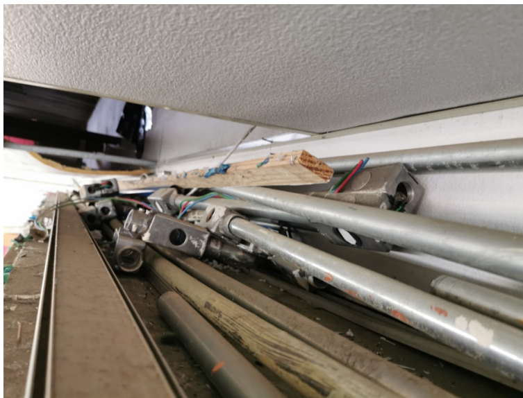
Foto 15 – Entulho deixado entre parede e forro do refeitório.
