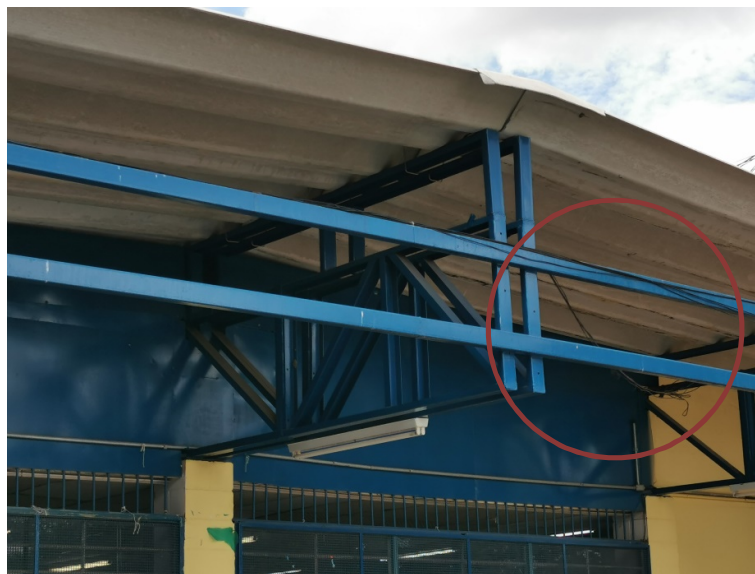
Foto 10 – Vista da estrutura metálica com condutores elétricos aparentes.
