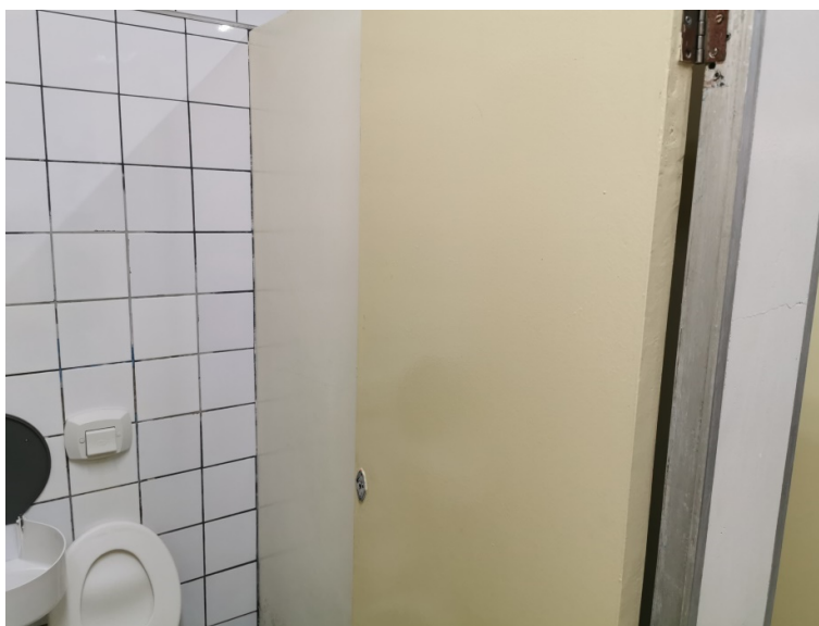
Foto 29 – Portas dos banheiros não substituídas, em desacordo com o Contrato.
