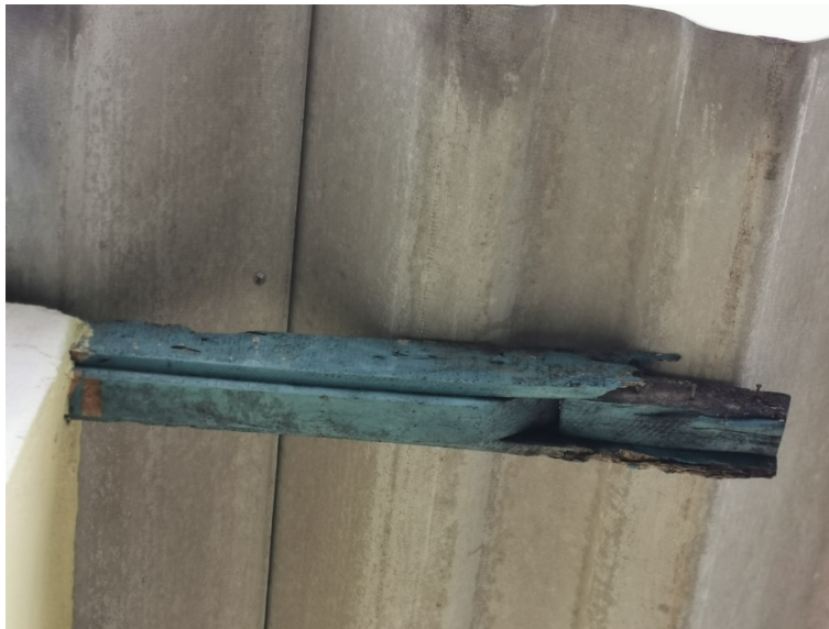
Foto 21 – Detalhe de terça da estrutura de madeira do telhado em mau estado de conservação e não substituída na reforma, em desacordo com o memorial descritivo.
