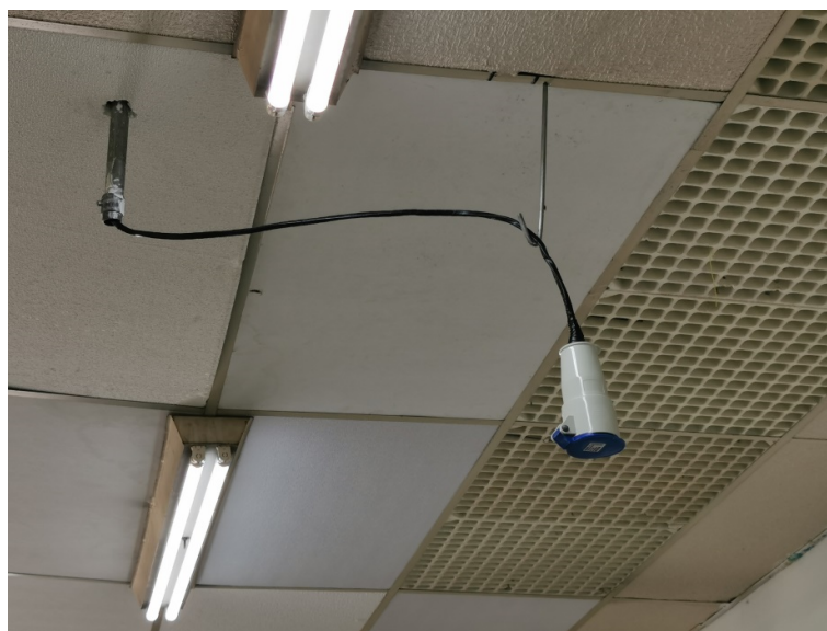
Foto 14 – Detalhe de tomada executada no refeitório. A solução adotada caracteriza uma instalação provisória e está em desacordo com ABNT NBR 5410:2004 e a Norma Reguladora NR-10.
