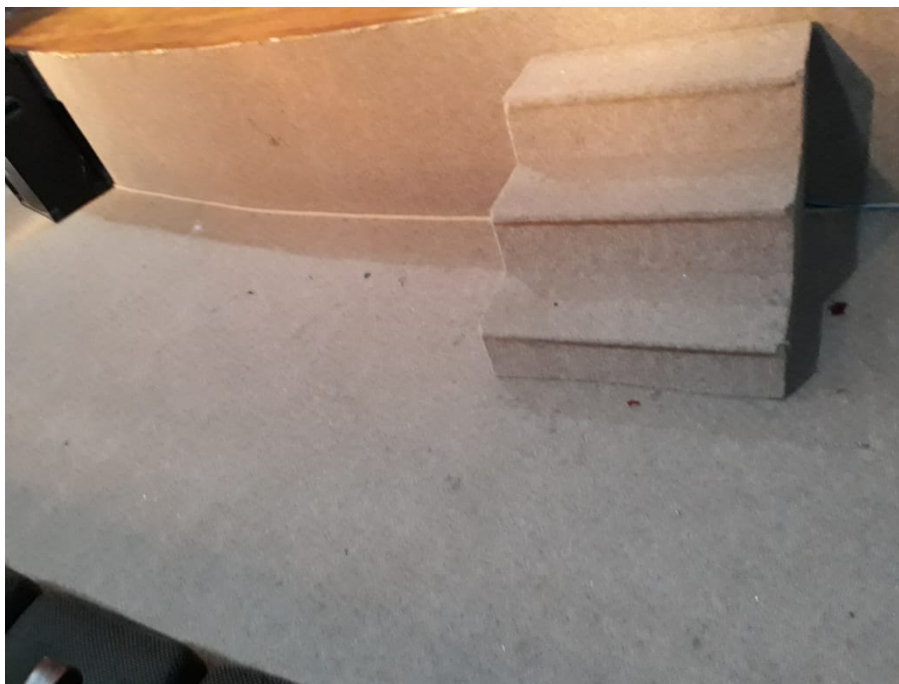
Figura 2 – Carpete do auditório sujo (não há aspirador de pó na unidade)
